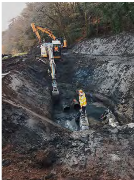
Casse du poste de relèvement des eaux usées sur le chemin du halage au Corniguel à Quimper (novembre 2020)
