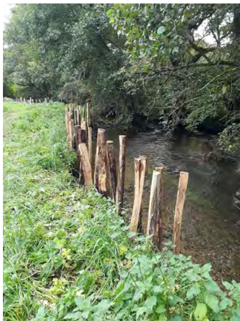
Restauration des berges par fascinage sur les rives du Jet pendant travaux
